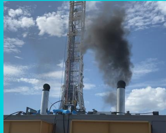
Dos motores diésel 3512C aumentaron su carga del 60% al 90%, y el motor de la izquierda cuenta con la solución de gestión inteligente de energía.
