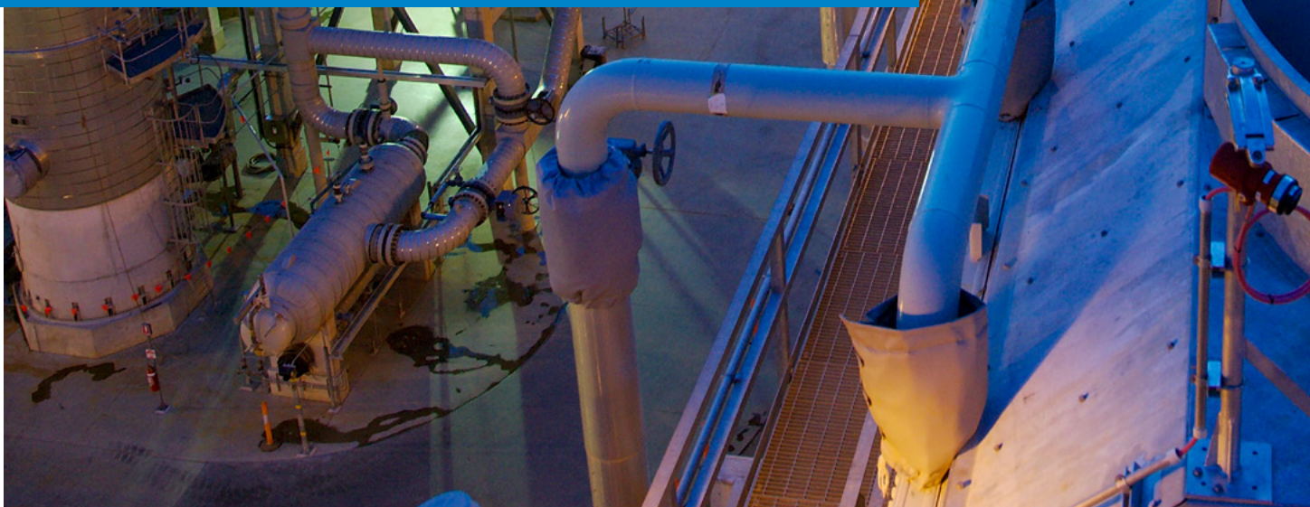
Planta de licuefacción de gas natural
