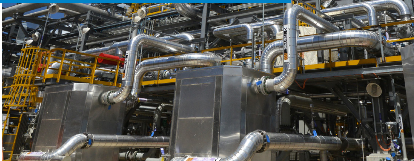
Planta de procesos de hidrocarburos
